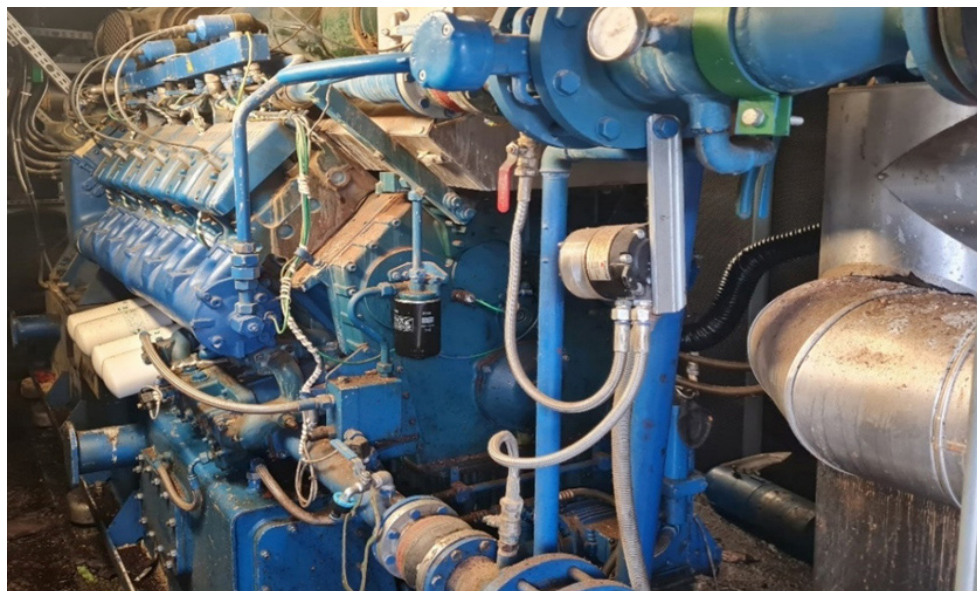
Zdjęcie 2. Silnik kogeneracyjny marki MWM pracujący na biogazie rolniczym
