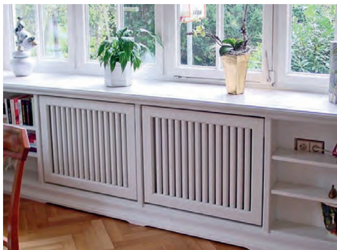
Zabudowane grzejniki choć estetycznie wyglądają, to ich konstrukcja zatrzymuje ok. 30 proc. ciepła, które dotarłoby do pomieszczenia, gdyby nie nałożona na nich estetyczna „klatka”. Fot. VanoVasalo
