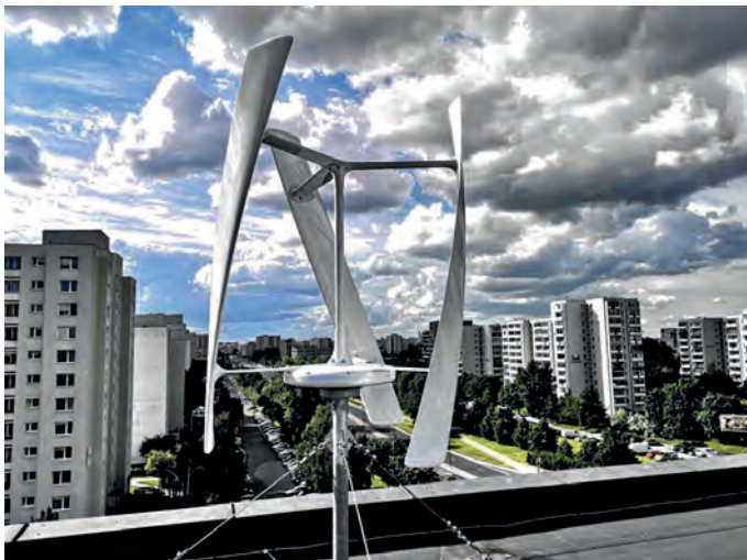
Na dachu ursynowskiego ratusza stanęły dwie turbiny. Mierzą po niespełna 3 metry i generują po 2 kW mocy każda. Będą dostarczać ok. 8 MWh energii elektrycznej rocznie. Fot. www.wysokienapiecie.pl
